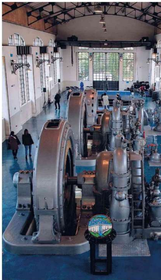
Interior de una de las centrales hidroeléctricas de Canal de Isabel II
